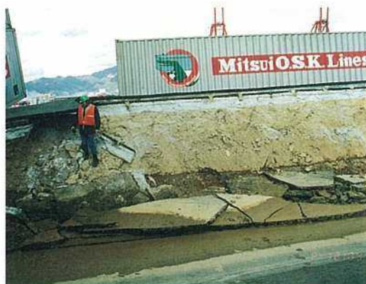
写真-1 岸壁ケーソン背後3m程度の陥没(ポートアイランド)
