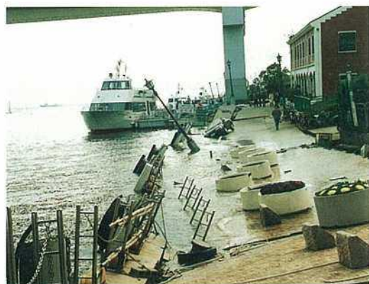
写真-2 小型岸壁の水没(メリケンパーク)
