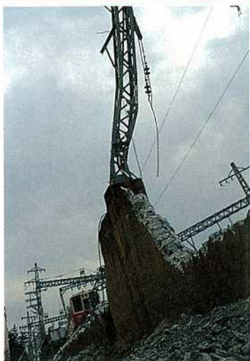
写真-3 鉄道構造物の崩壊による不通
