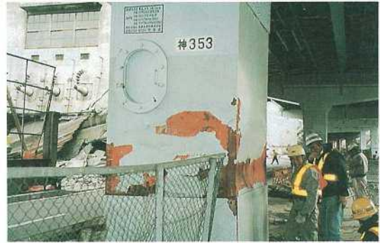
写真-2 矩形断面鋼橋脚の座屈例2
