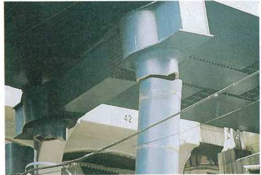
写真-8 鋳鉄製橋脚の脆性破壊例
