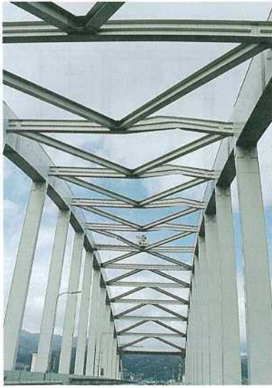
写真-14 アーチリブ連結支材の座屈
