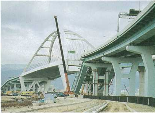
写真-11 単純支持箱桁橋の落橋例
