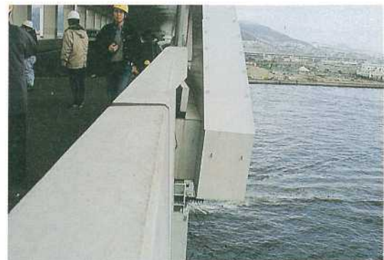
写真-13 ダブルデッキアーチ橋の損壊
