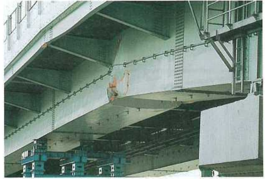
写真-15 連続鋼箱桁橋の曲げ座屈
