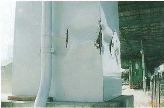
写真-1 矩形断面鋼橋脚の座屈例1
