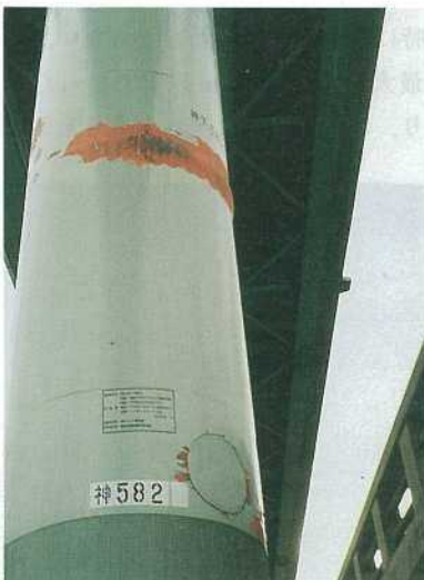
写真-3 円形断面鋼橋脚の座屈例1
