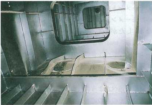
写真-16 座屈した連続鋼箱桁橋の内部
