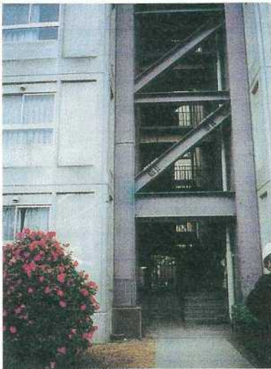
写真-7 高層鉄骨建物の脆性破壊例
