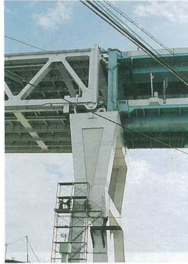
写真-12 斜張橋のペンデル沓の破壊例
