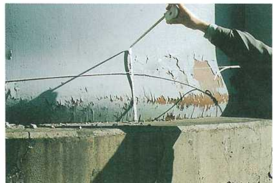
写真-4 円形断面鋼橋脚の座屈例2
