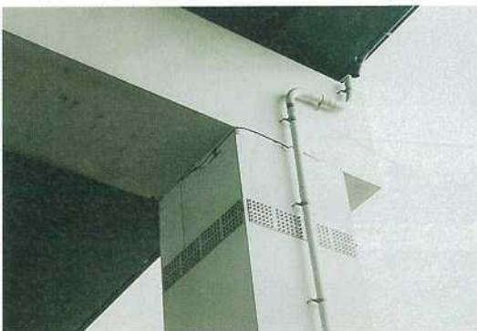
写真-5 門型ラーメンの脆性破壊例1
