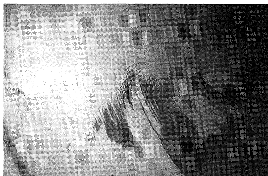
写真-1 市東部シールドトンネル 2次覆工のコンクリートひびわれ
