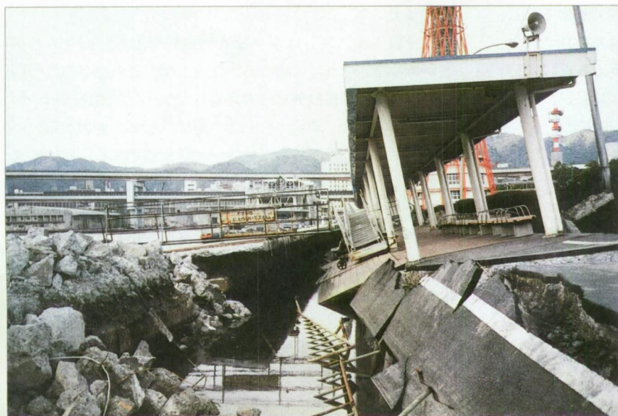
写真-1 阪神・淡路大震災の神戸港の岸壁の被害
