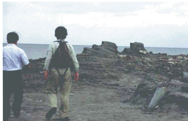
写真-2 1991年の高潮で壊滅したチッタゴンの海岸堤防
