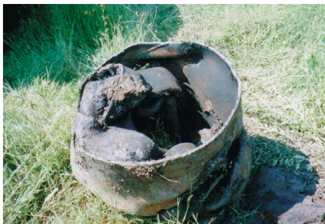
写真-3 テペタラ駅における鋼製の基幹送水管の座屈 （破損したものが地面に仮置きされている）
