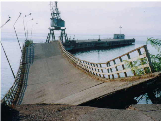
写真-6 栈橋に取り付く橋の沈下
