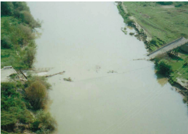
写真-5 アリフィエ・サカリヤ川横断橋の落橋
