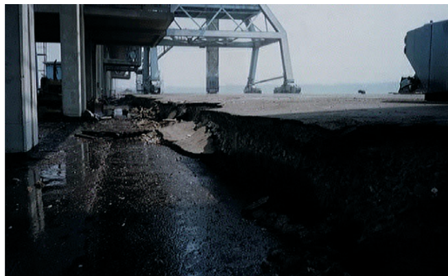
写真-5 台中港ケーソン岸壁背面の沈下状況
