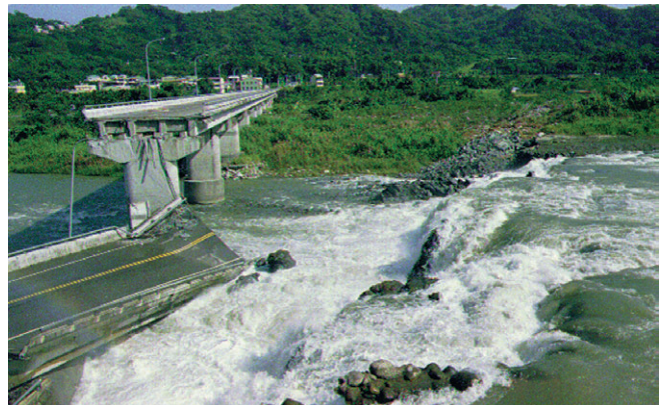
写真-1 碑豊橋の被災状況
