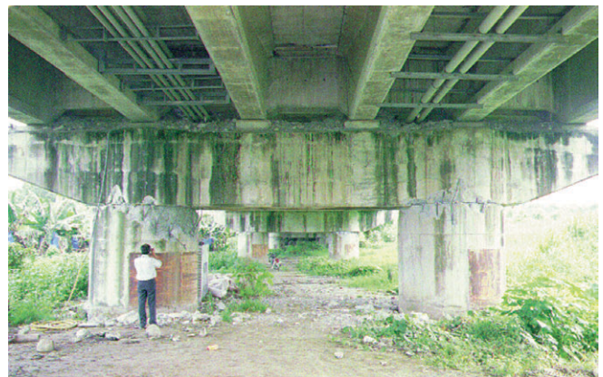
写真-2 炎豊橋の被災状況
