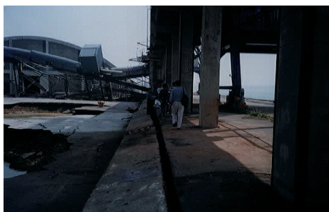
写真-6 ベルトコンベヤー施設の被害状況
