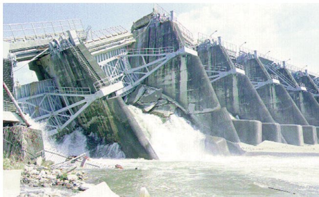
写真-3 石岡ダムの大規模な破損状況（下流側から撮影）
