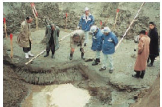
写真-3 薬液注入試験施工の掘削検証（超微粒子シリカ、ゲルタイム8時間、浸透注入、浸透範囲200cm以上、液状化対策のため必要強度は5～10kPaに設定）
