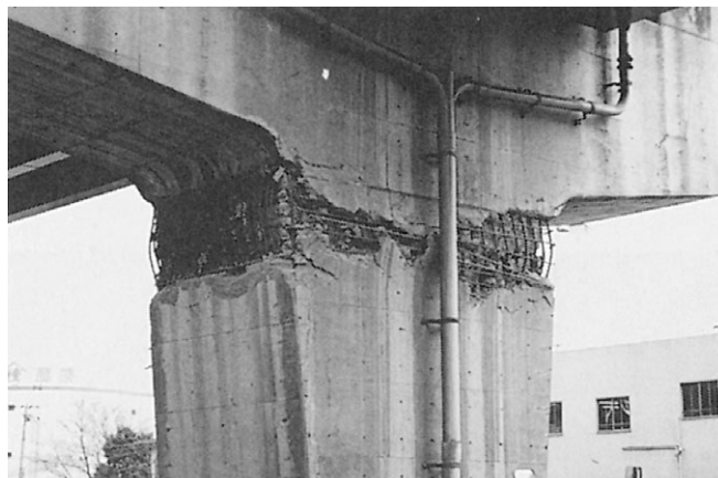
写真-3 打継目の損傷 1)
