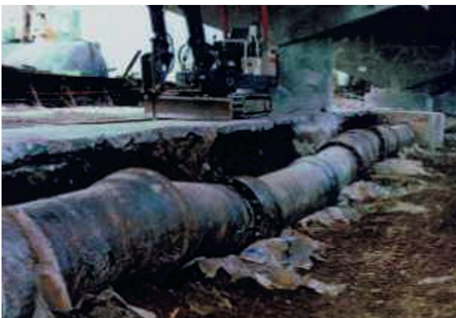
写真-1 大きな地盤変状に耐えた耐震管路 (耐震継手付きダクタイル鑄鉄管)
