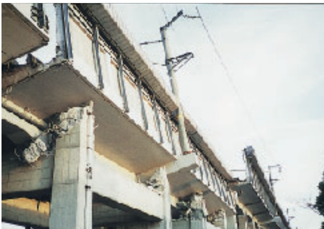
写真-1 柱がせん断破壊した高架橋
