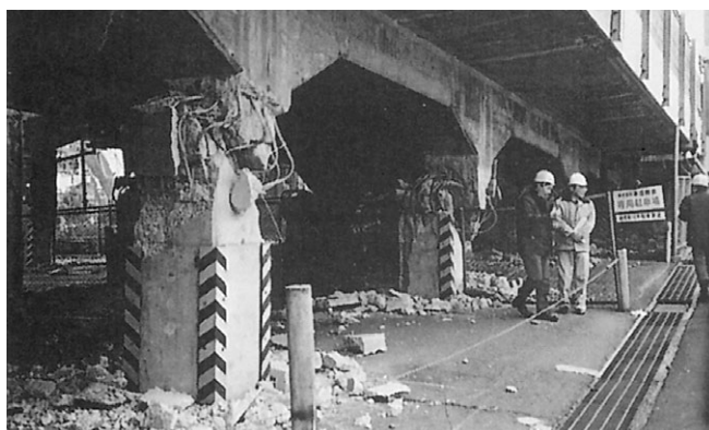
写真-2 橋脚のせん断破壊による鉄道高架橋の崩壊 1)
