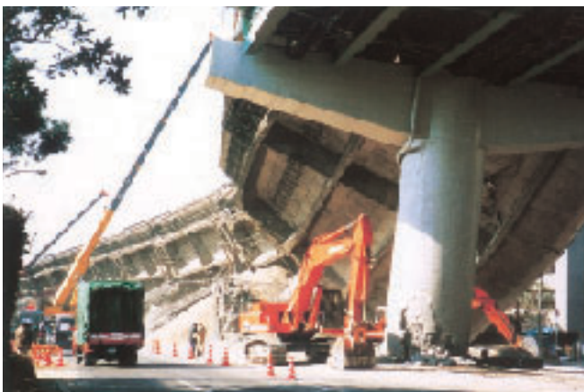
写真-1 橋脚のせん断破壊によるピルツ橋の倒壊 1)
