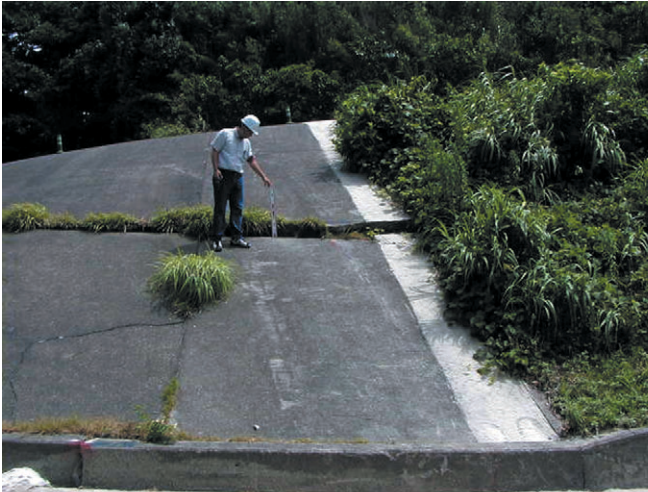
写真-2 上下道路の中間斜面の亀裂
