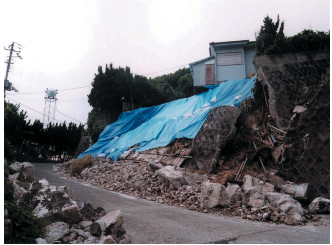
写真-3 石積擁壁の崩壊
