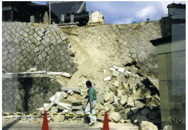
写真-2 呉市西中央5丁目お寺の空石積擁壁の崩壊
