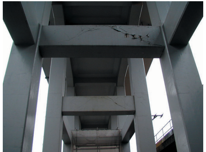
写真-1 二層ラーメン中梁損傷部
