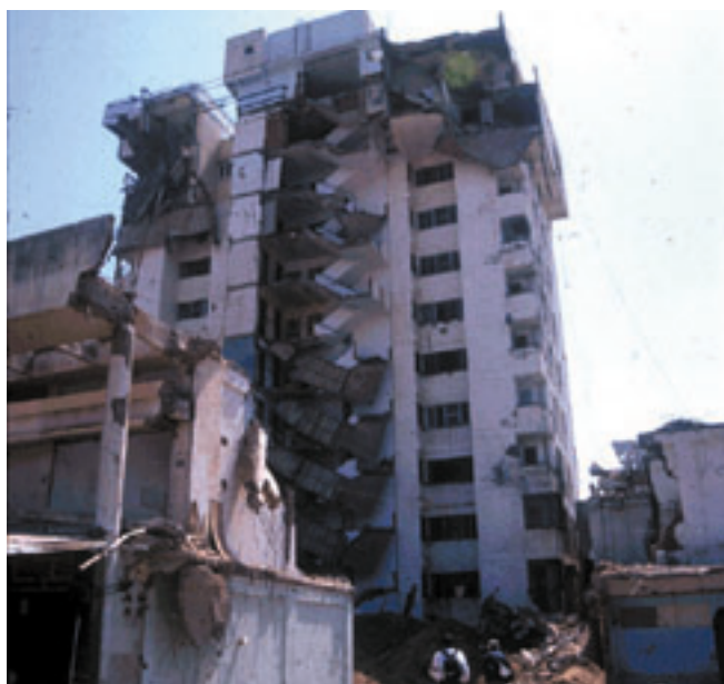
写真-7 アーメダバード市内の10階建てRC建物の被害（同形式の建物が前方で完全崩壊していた）
