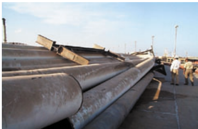
写真-5 鋼製架構から崩れ落ちたパイプライン
