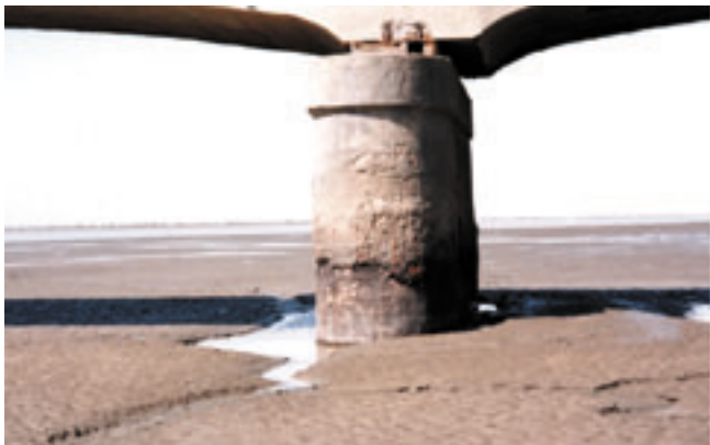
写真-2 地盤変状に伴う橋脚の移動
