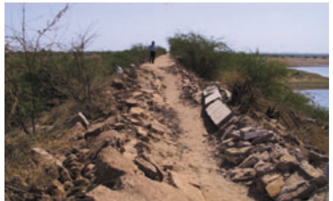
写真-4 スーヴィーダムの堤頂部の沈下
