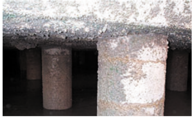
写真-3 カンドラ埠頭下のパイロンに生じた曲げクラック
