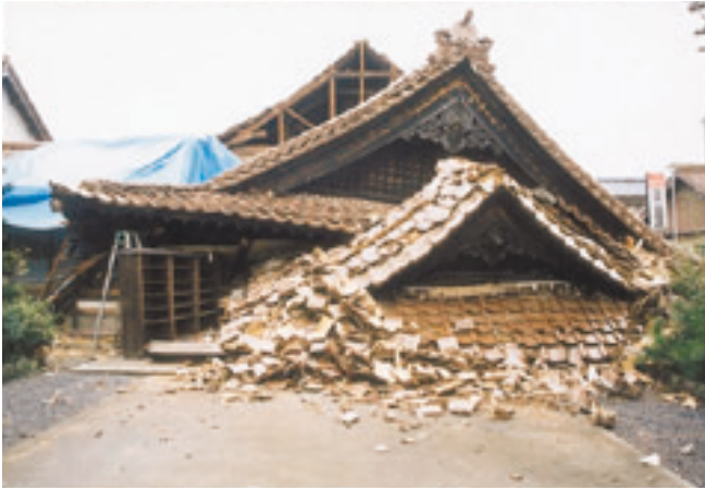
写真-1 住宅被害は、約1万7000棟に上り、ブルーシートが掛けられた屋根が並ぶ。(日野町)(日本海新聞)
