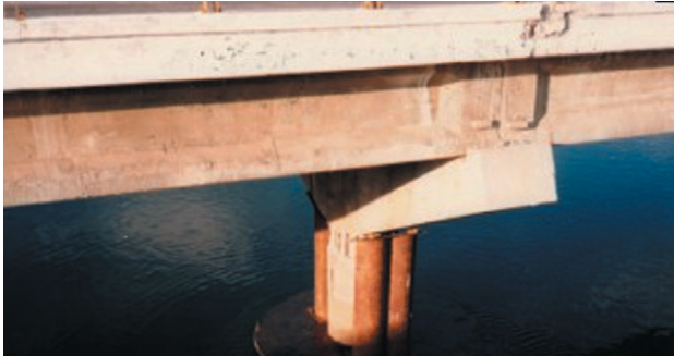
写真-3 ラサロ・カルディナスのバスサス河に架かるコアステ橋の被害
