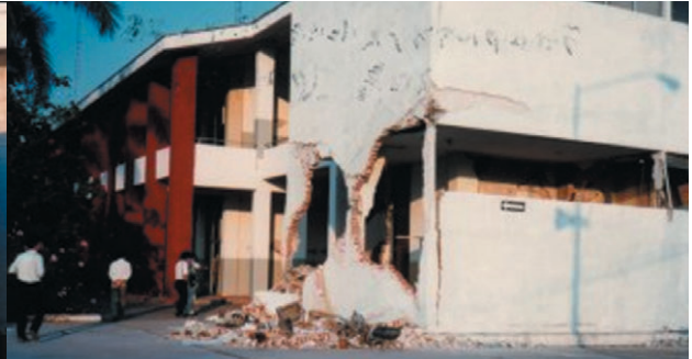
写真-4 ラサロ・カルディナス市内の建物の被害
