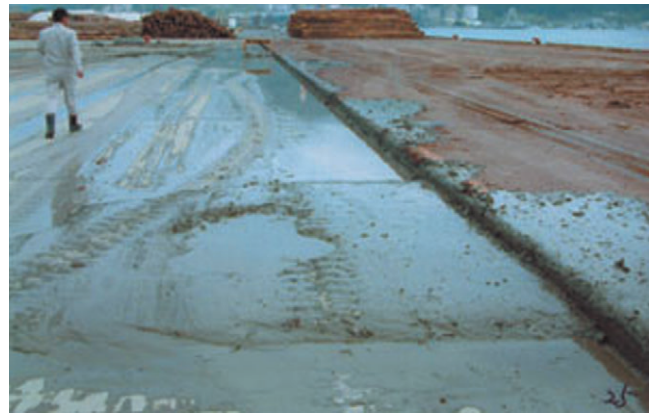
写真-5 岸壁背後のシルトの堆積
