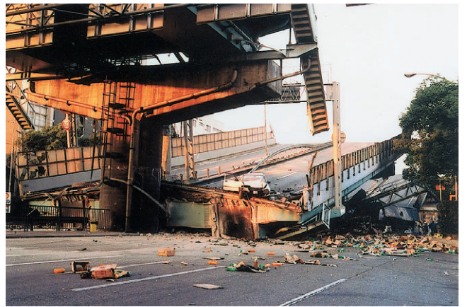
写真-1 兵庫県南部地震で倒壊した阪神高速道路
