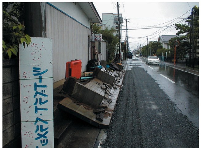
写真-1 矢本町におけるブロック塀の倒壊
