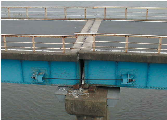
写真-5 小野橋桁間の衝突・支承の損傷状況
