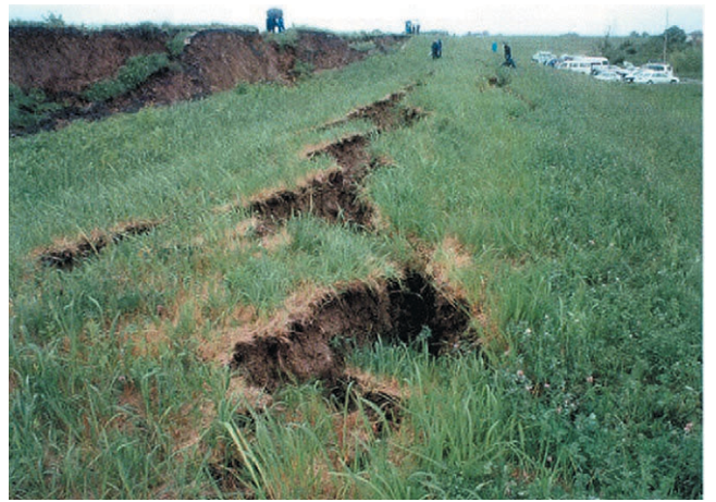
写真-4 鳴瀬川木間塚大橋下流側堤防右岸側の法面崩壊 （提供：国土交通省東北地方整備局北上川下流工事事務所）
