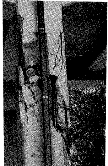
写真-1 柱のせん断破壊の例
