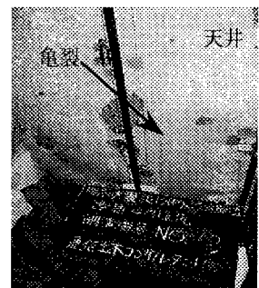
写真-1 一般部被災状況
