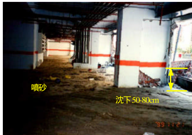
写真-2 建物の沈下と半地下駐車場の一面の噴砂
