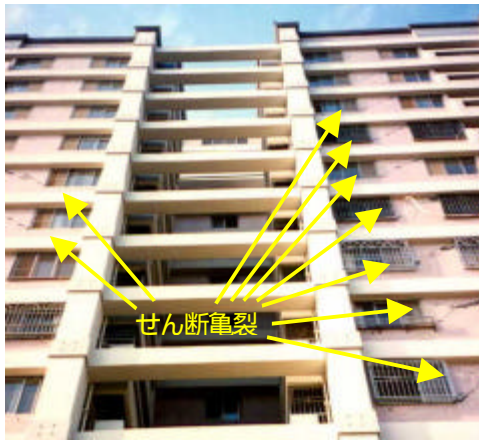
写真-3 建物東側壁面の被害
