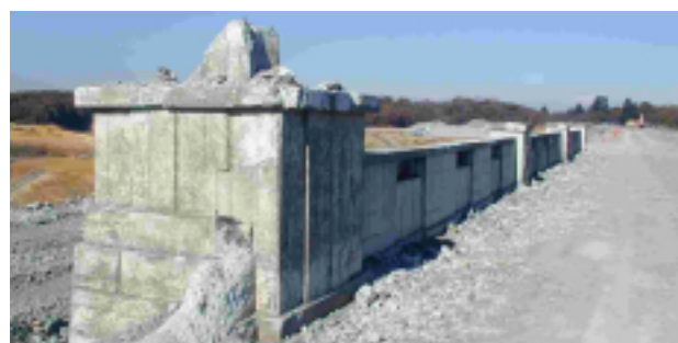
写真-3 発見されたコンクリート製旧高欄
