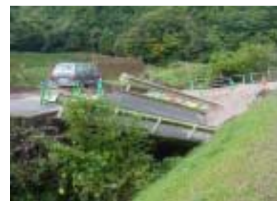
図-6 落橋の状況
