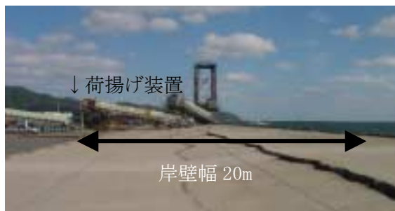
図-1 岸壁の沈下の状況
