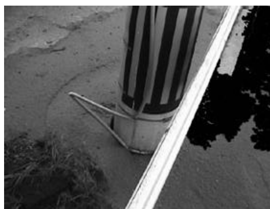
写真-1 液状化による電柱の沈下及び噴砂跡
