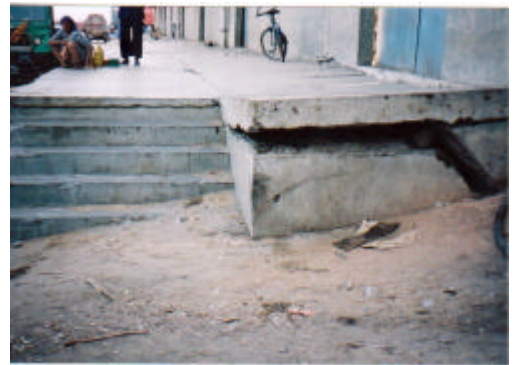
写真-5 液状化による上屋の被害
