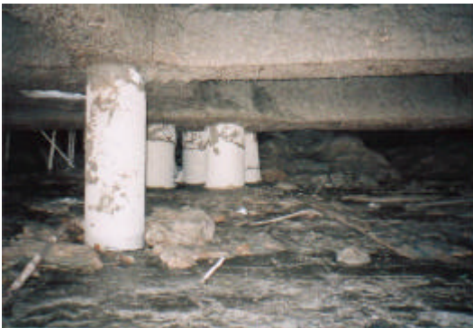
写真-4 陸側の RC 杭に生じたコンクリートの剥落
