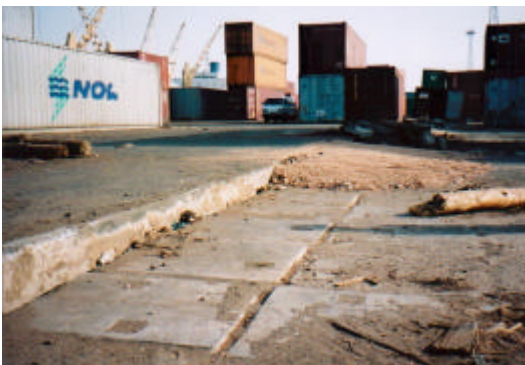
写真-6 液状化による棧橋-背後地盤間の段差
