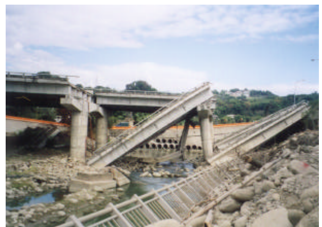
写真-1 石圍橋の被害
