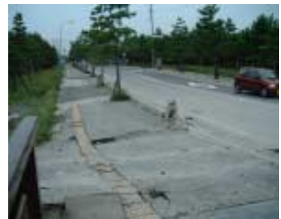
写真-2 流動による路面の変状
