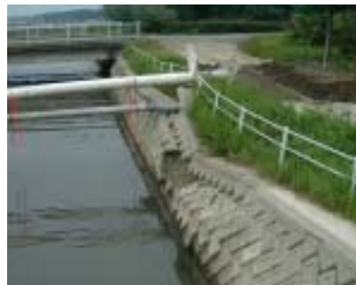
写真-1 流動による護岸の変状
