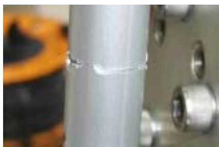
写真2．アルミポールのき裂
