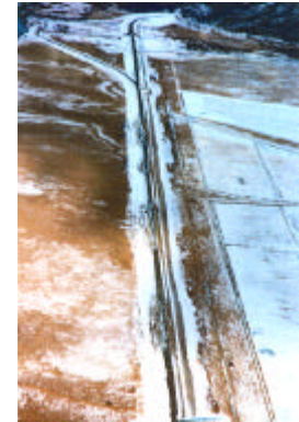
Fig.1 釧路川左岸堤防の被災状況
