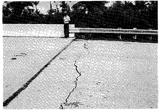
写真-6 Inarajan 橋の橋台背面の沈下と舗装の亀裂
