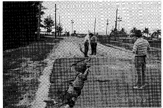
写真-2 軍港への取付道路の液状化被害
