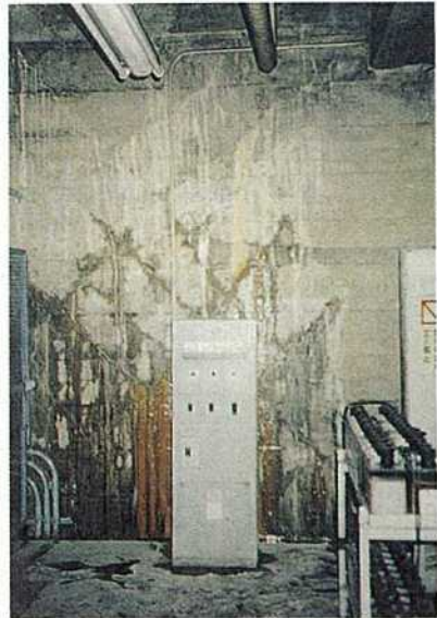
写真-3 電気室のひび割れ状況
