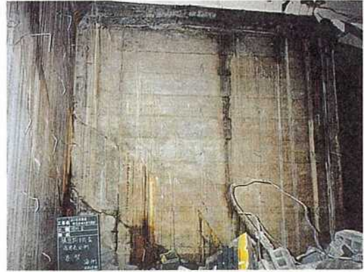
写真-2 妻壁(海側)のひび割れ
