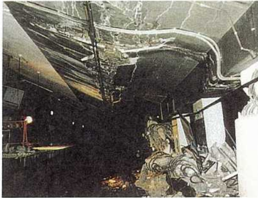
写真-1 中柱の圧壊および上床版の陥没
