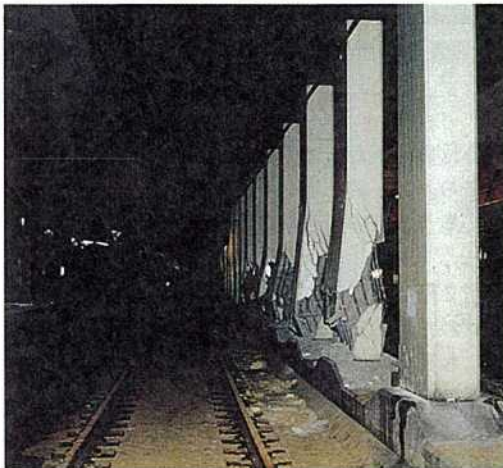
写真-4 中柱の損傷
