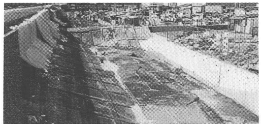
写真-4 淀川右岸の被害状況
