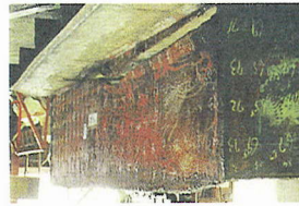
(c) 北面フランジ (詳細調査時)
