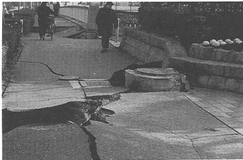
(a) 汐風橋西詰め(南側)のマンホールの抜き上がり
