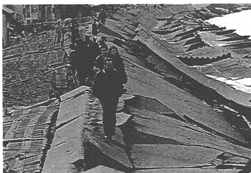
写真-5 淀川左岸堤防の被災(朝日新聞社提供)
