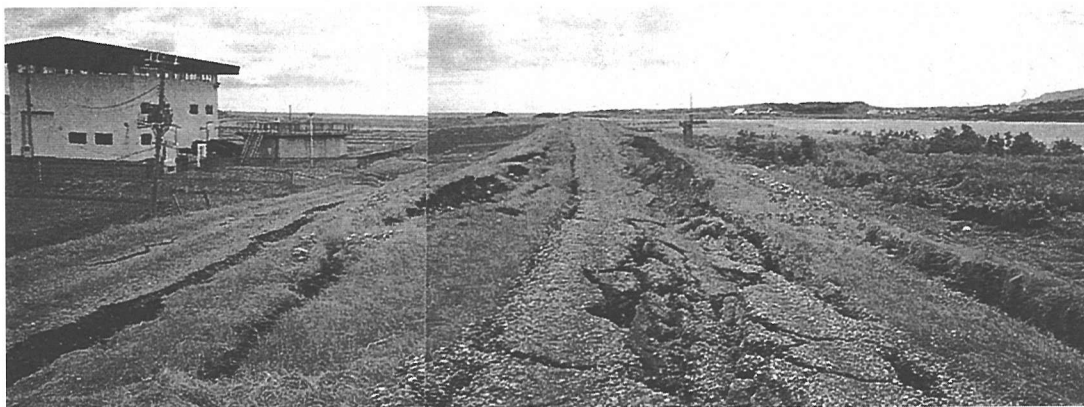
写真-4 後志利別川堤防の被災(左岸 兜野地先)
