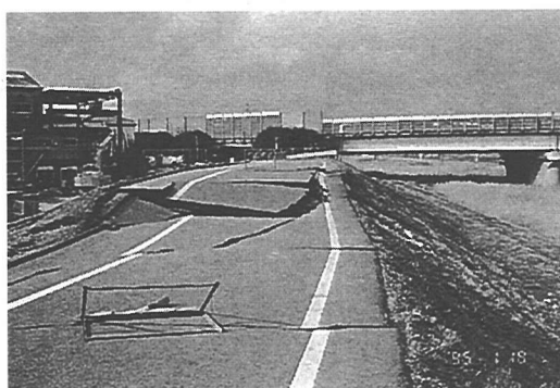
写真-6 猪名川堤防の被災(派川藻川右岸 0.4km)
