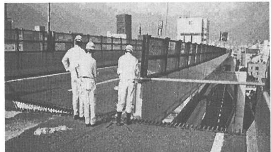
写真-5 橋桁の横ずれ (H橋, 後述)
