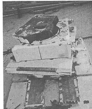
写真-4 支承割れ (H橋, 後述)
