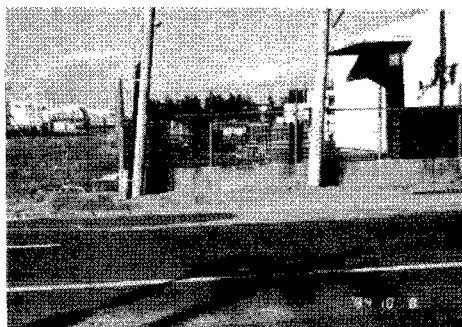
写真5 電柱の傾斜(釧路港西港第1埠頭)
