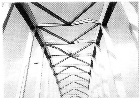
写真-1 上横繫ぎ材の座屈状況 (支材 L11, L9, および斜材 D11 の座屈)
