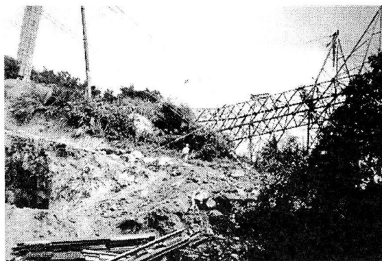
写真-1 倒壊した345kV超高圧送電鉄塔 (中寮～峨眉間の#203)
