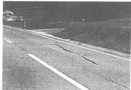
写真-1 アスファルト舗装の亀裂
