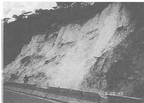
写真-3 Los Chorros におけるしらす斜面崩壊
