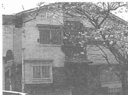
③ 亀山神社周辺の民家、材質の異なる壁が落ちている
