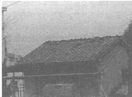
① 亀山神社周辺の民家棟瓦の被災状況
