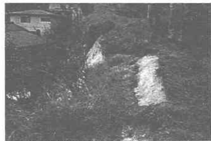
⑥呉市神原町の民家裏斜面の崩壊
