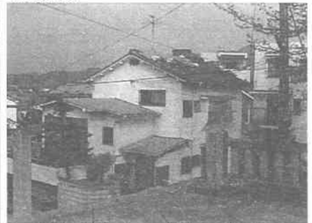
② 亀山神社周辺の民家棟瓦の被災状況
