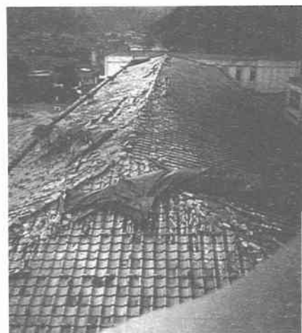
⑤河内小学校校舎の棟瓦の被害状況
