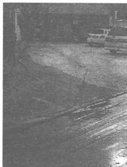
写真-1 地点 A の液状化
