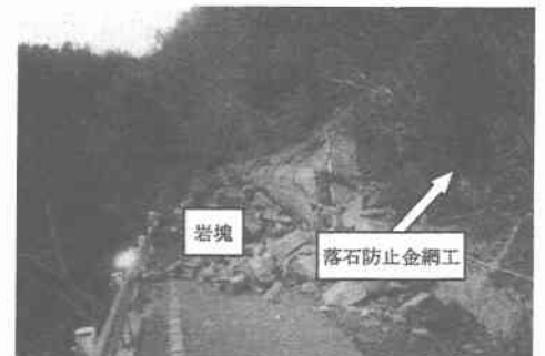
写真-2 東和町油宇における岩盤崩壊
