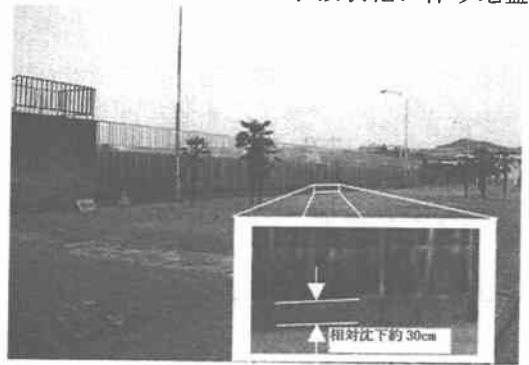
写真-3 米子市安傍下水処理場の地盤の沈下
