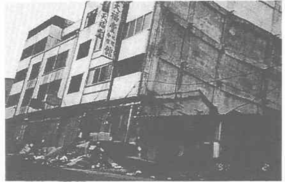
写真-2 断層変位による建物一群の傾斜（石岡）
