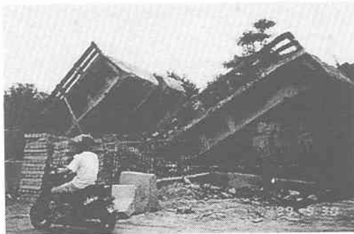
写真-5 19 の内 9 径間が落橋した一江橋の被害
