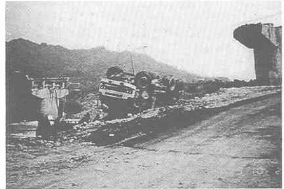
写真-4 鉛直と水平の断層変位による碑豊橋の被害
