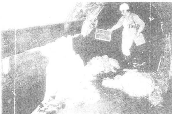
写真-6 コンクリートの塊状崩落
