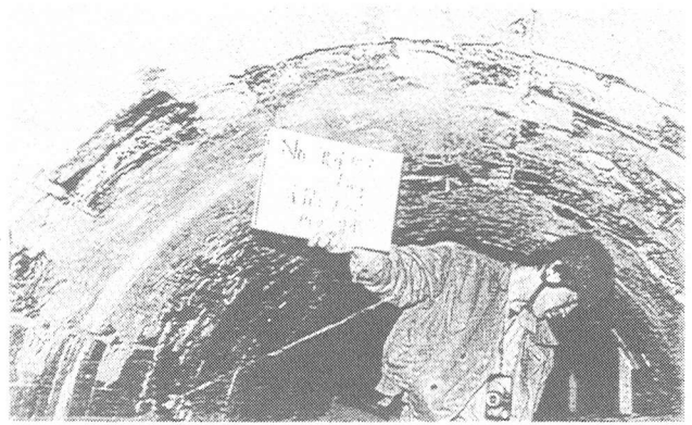
写真-4 セグメントの破損
