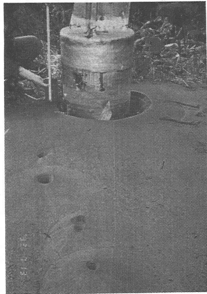
写真-2 送電鉄塔基礎部分の噴砂の様子
