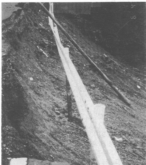
路肩の崩落(国道504号線中ノ屋敷～平八重間)
