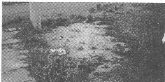
阿久根漁港で生じた液状化跡(水産加工団地)
