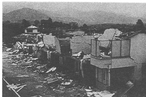
写真-2 屋根と外壁が倒壊した住宅の被害例 (提供: E. RODRIGUEZ GRANDOS)
