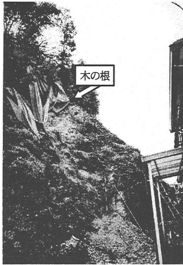
写真-7 岩国市門前における表層崩壊・岩盤崩落
